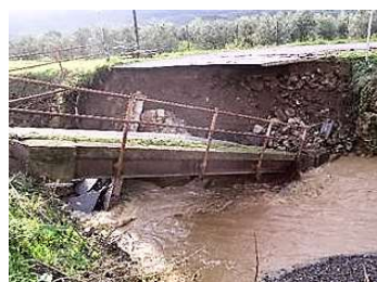
ponete crollato a seguito alluvione
