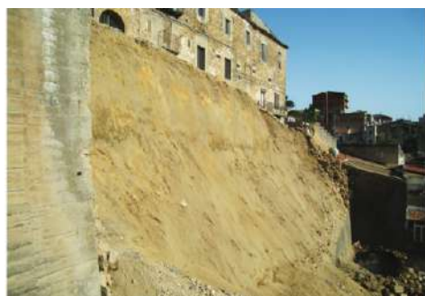
Area soggetta a smottamento
