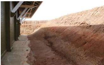
problema : frane nel perimetro dell'edificio
