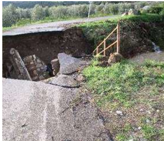
Crollo del ponte visto dalla strada
