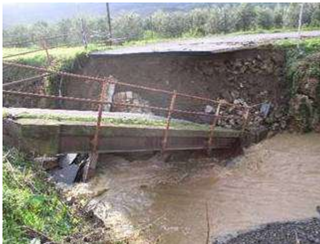
Crollo del ponte visto di lato
